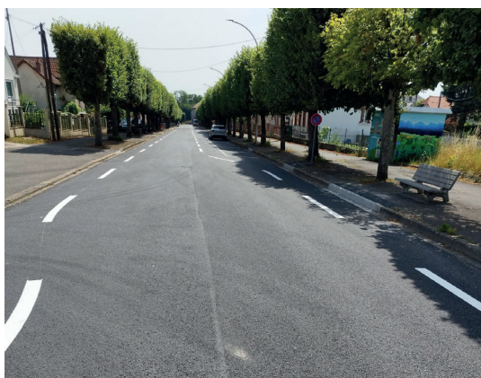
■ 30 juillet - réhabilitation de l'avenue de la République, un plateau a aussi été créé au droit de l'école de la Gare.
