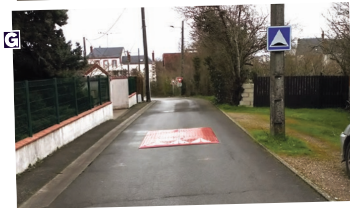
■ Pose de coussins berlinois chemin de la Fourcherie et rue de la Croix du pavé.
